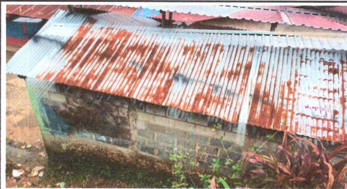
Foto 3: Cocina: Cubierta de lamina en mal estado.
